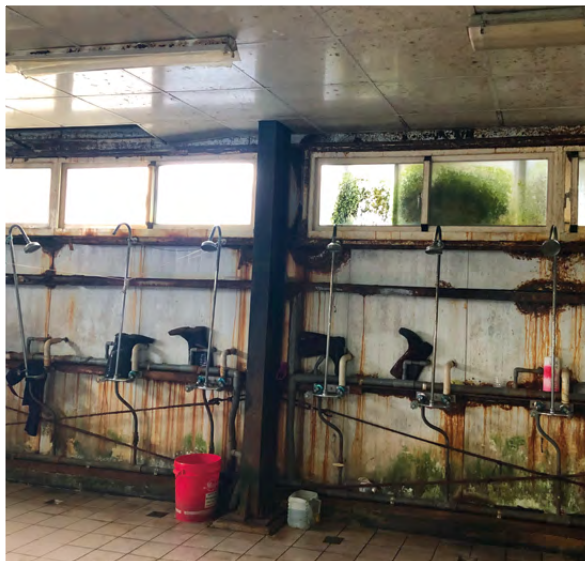
大溪漁港岸置中心的淋浴設備沒有隔間
